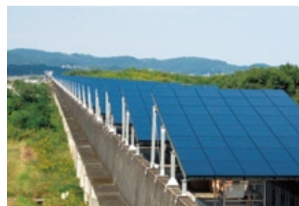
3.6kmのリアモーターカー実験線の高架上に設置したCIS薄膜太陽電池(宮崎県)
