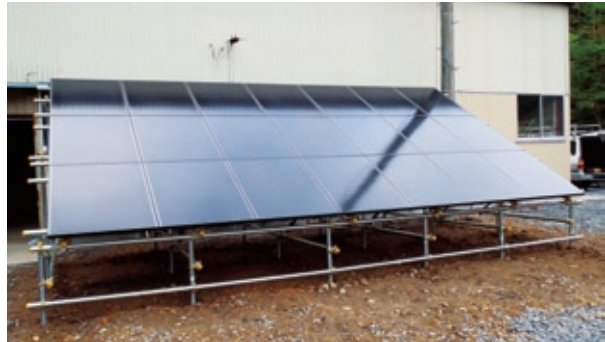
造船所に設置した太陽光発電システム
