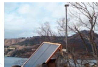
海岸近くに設置した街路灯
