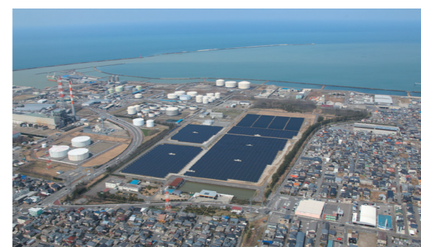
太陽光発電所
