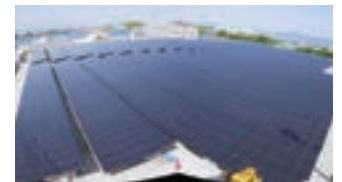
CSDソーラー徳島太陽光発電所
